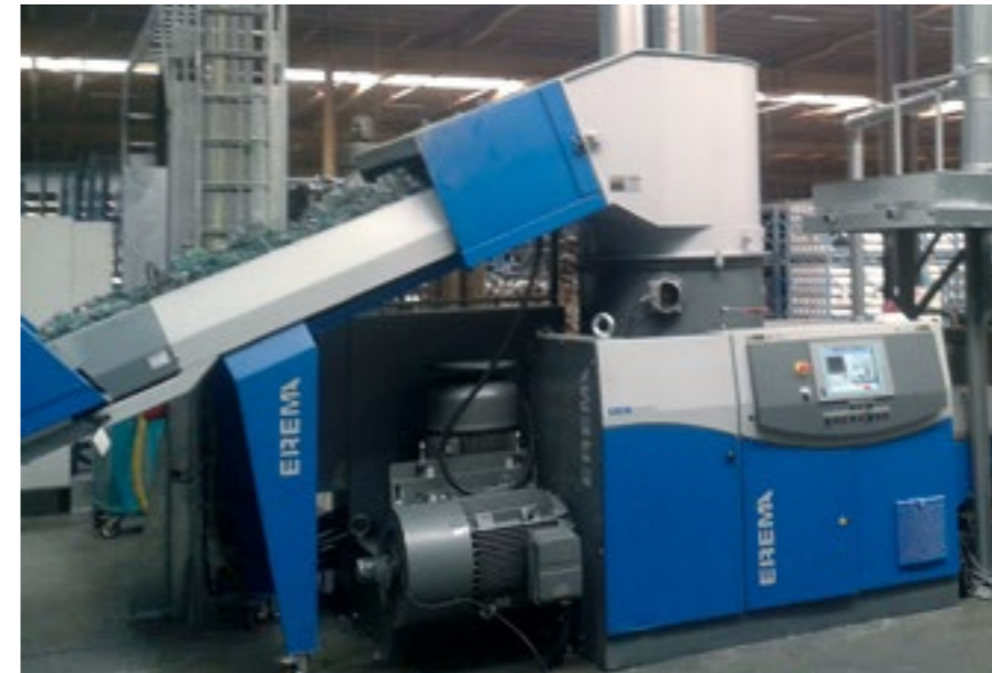
Die COREMA® 1109 T Anlage bei Beaulieu Technical Textiles in Belgien sorgt für eine effiziente Entgasung der Spinnölanteile im Schneidverdichter
