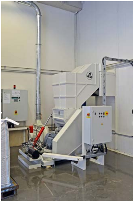
Im Zuge der Kapazitätsaufstockung wurde als Ergänzung eine Mühle vom Typ Hellweg M600/450 installiert, die auch größere Brocken ohne Vorzerkleinerung in einem 1-stufigen Prozess auf Granulatgröße bringt.
