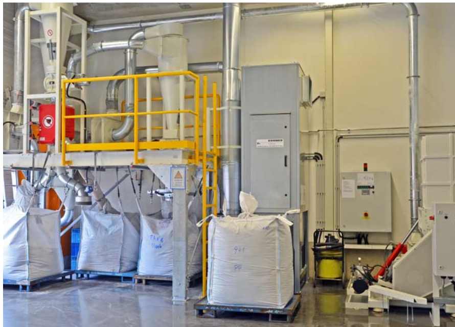
Beide Mühlen sind inline mit der Entstaubungs- und Abfüllanlage für Big-Bags gekoppelt.
