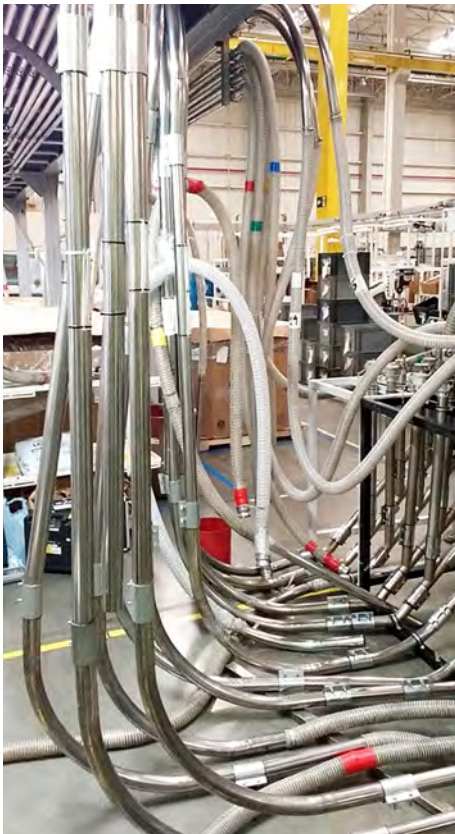
Detail der Anlage vor Aufnahme der Arbeiten durch WITTMANN BATTENFELD do Brasil.
