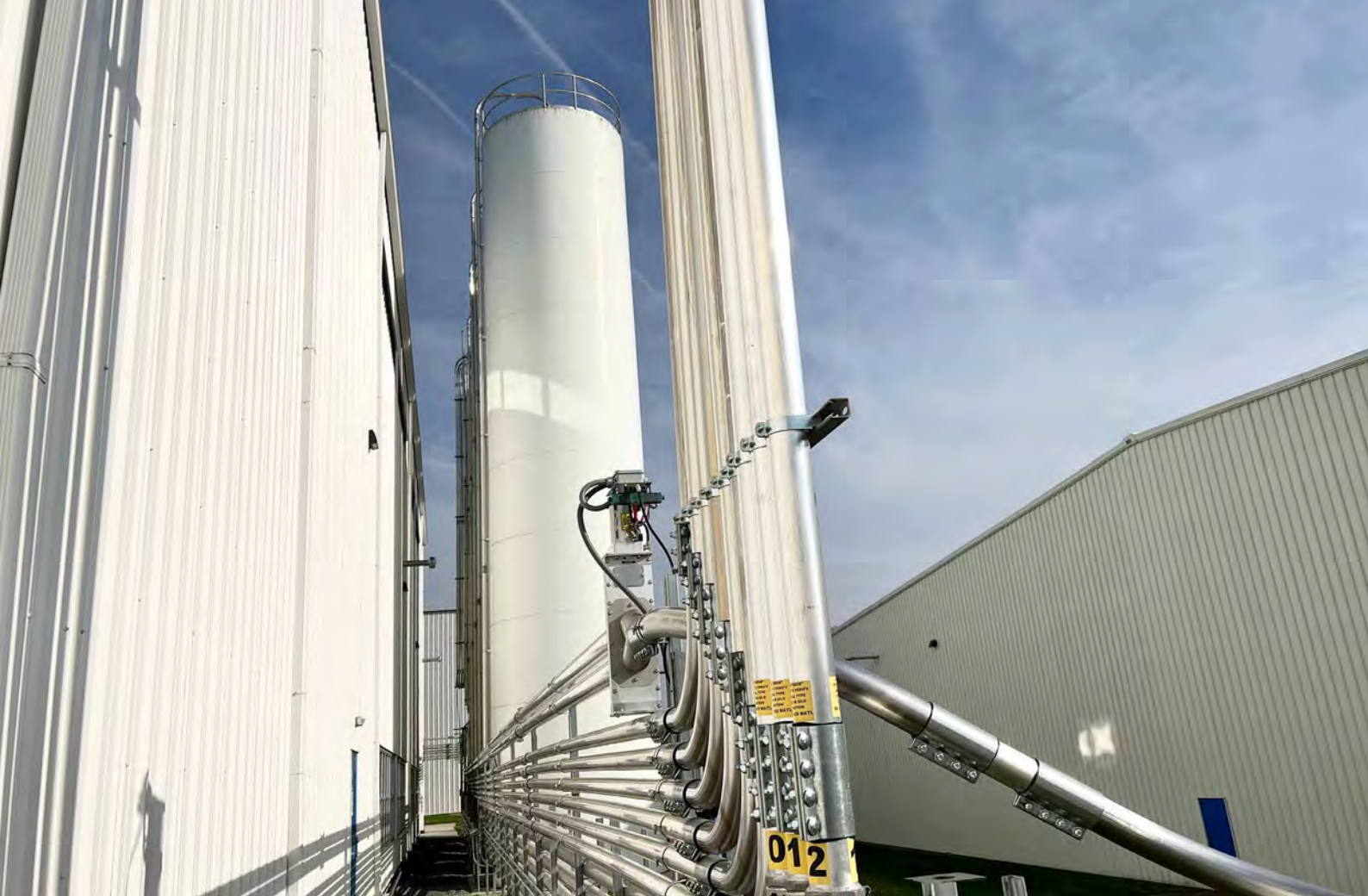
WITTMANN entwarf und installierte das Monoflo Materialfördersystem (inklusive Verrohrung und Silos), durch welches das wiederaufbereitete Material in die entsprechenden Silos bzw. zu den Verarbeitungsstätten gefördert wird.
