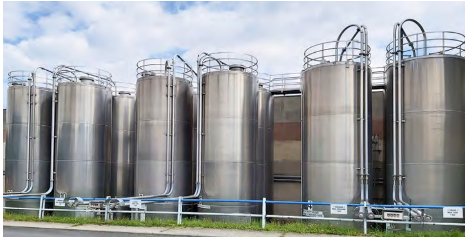
Die Material-Außensilos bei Husqvarna Manufacturing CZ s.r.o. in Vrbno pod Pradědem, Tschechische Republik.
