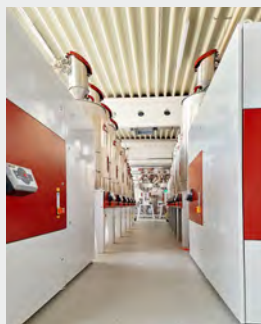
S. 14: Neue Förderanlage bei Praher (A).
