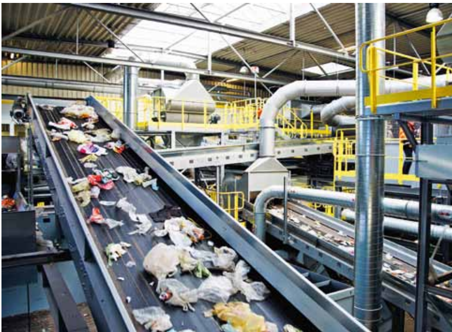
WAA LOBBE, modernste Sortieranlage in Europa mit 80.000 Tonnen Jahreskapazität
